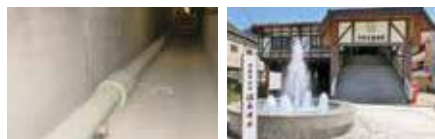
トンネル内引湯管
