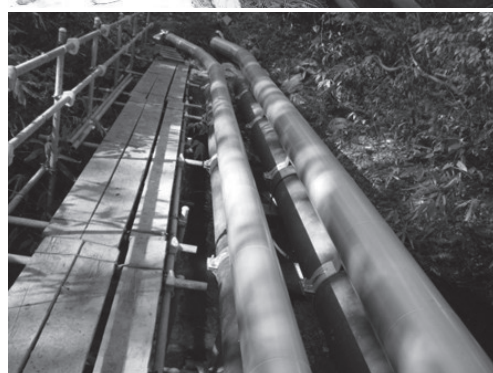
図10 温泉引湯配管
