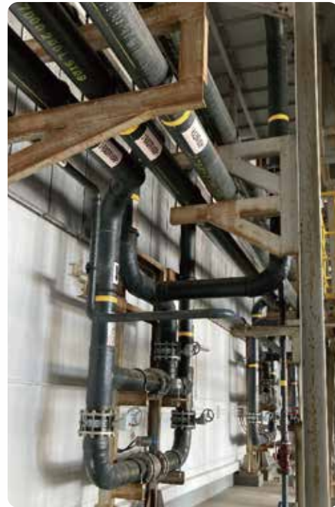
清掃工場／洗煙装置周り配管
