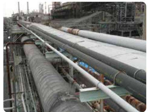
化学工場／薬液配管
