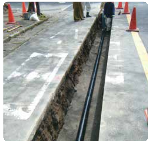
温泉施設／配湯管(保温付)
