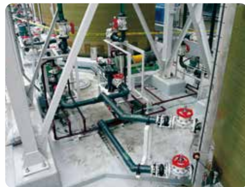
製鉄所／塩酸設備 薬液配管
