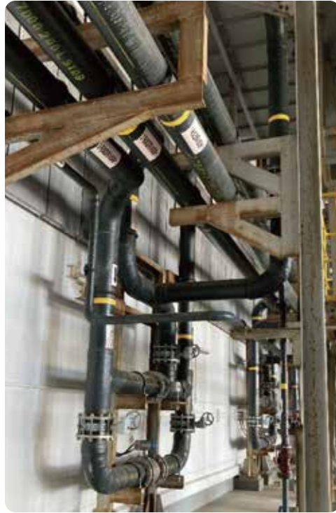
清掃工場／洗煙装置周り配管
