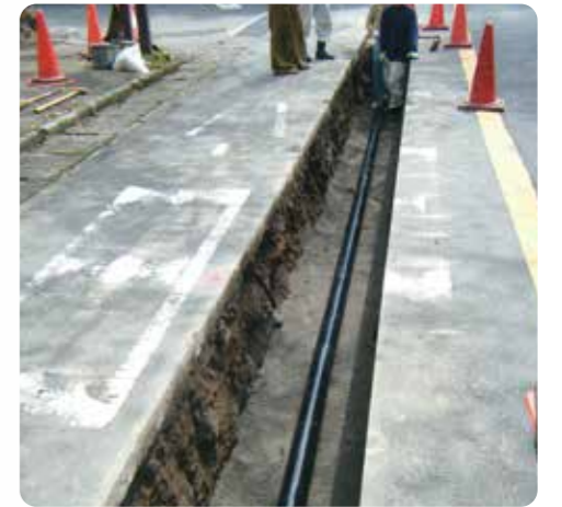
温泉施設／配湯管(保温付)
