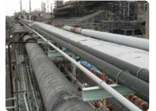
化学工場／薬液配管
