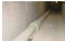
トンネル内引湯管
