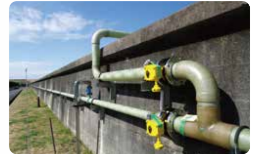
浄水場／薬液配管
