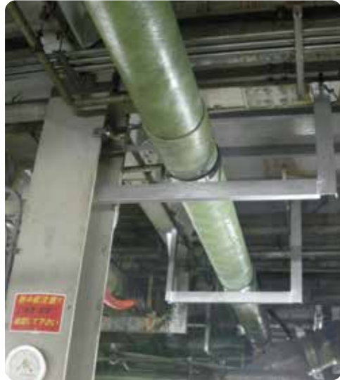
ごみ処理施設／酸性水配管
