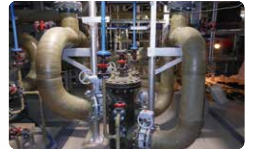
清掃工場／洗浄水配管
