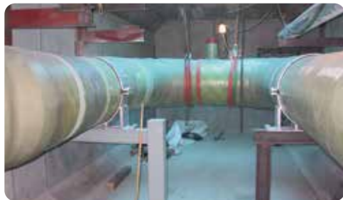
発電所／海水配管
