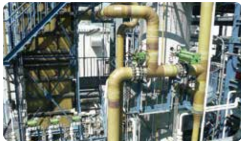
火力発電所／ダクト管
