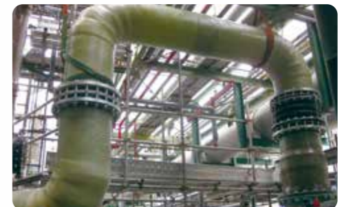
化学工場／薬液配管
